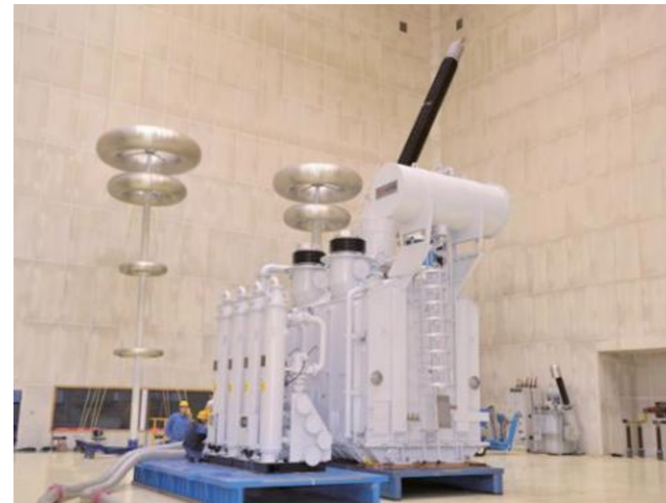
乌东德水电站 DSP-375000/500
