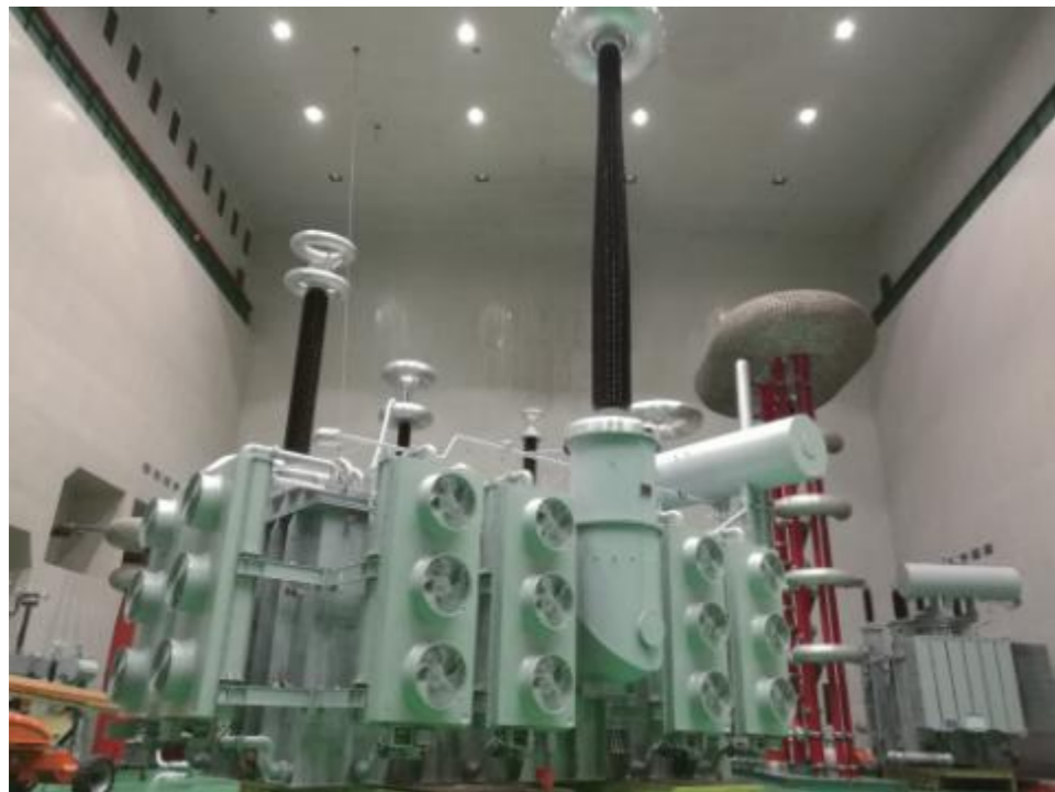
淮南 - 上海特高压工程苏州站 ODFPS-1000000/1000
